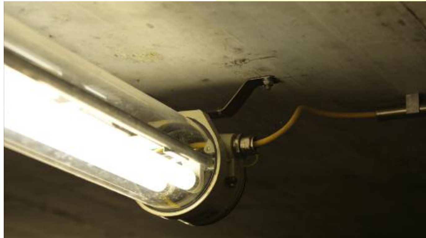
Abbildung: AB 12 Leuchte installiert über Klärbecken.
