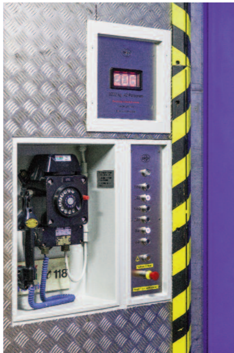
Bild III. Explosionsgeschützte Stockwerksanzeige, Bedienung des Aufzugs und Ex-Telefon Panneau antidéflagrant d'indication des étages et de commande et téléphone Ex.
