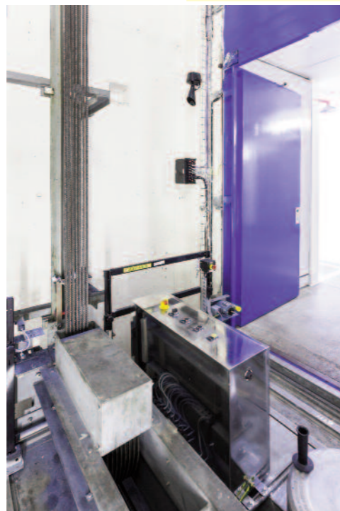
Bild III. Explosionsgeschützte Geräte und Installation auf dem Aufzugsdach Appareils et installation sur le toit de l'ascenseur
