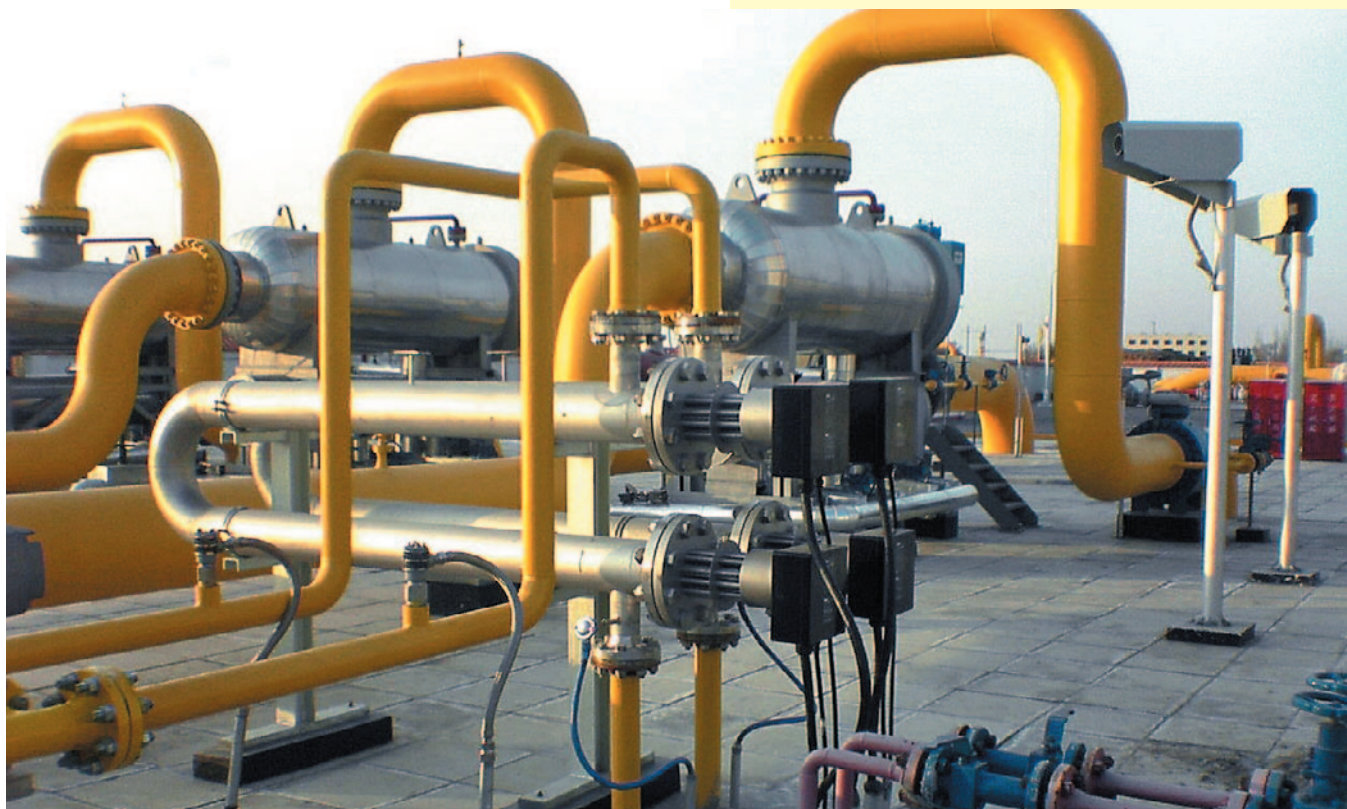
Erdgaspipeline von West- nach Ostchina 4300 km, Beheizung des Gasstroms vor jeder Druckreduzierung (Joule-Thomson-Effekt bezeichnet die Temperaturänderung eines Gases bei einer Druckminderung).
