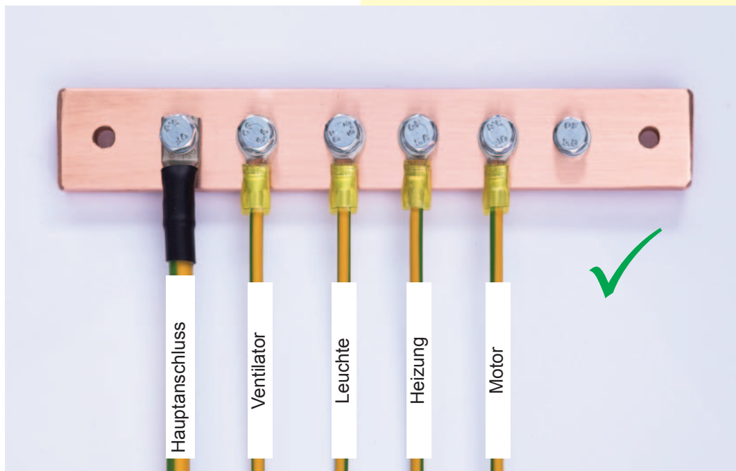
Schutzpotenzialschiene mit Hauptanschluss mindestens 6 mm 2 und Abgänge mindestens 4 mm 2 Rail de protection équipotentielle avec raccordement principal d'au moins 6 mm 2 et sorties d'au moins 4 mm 2
