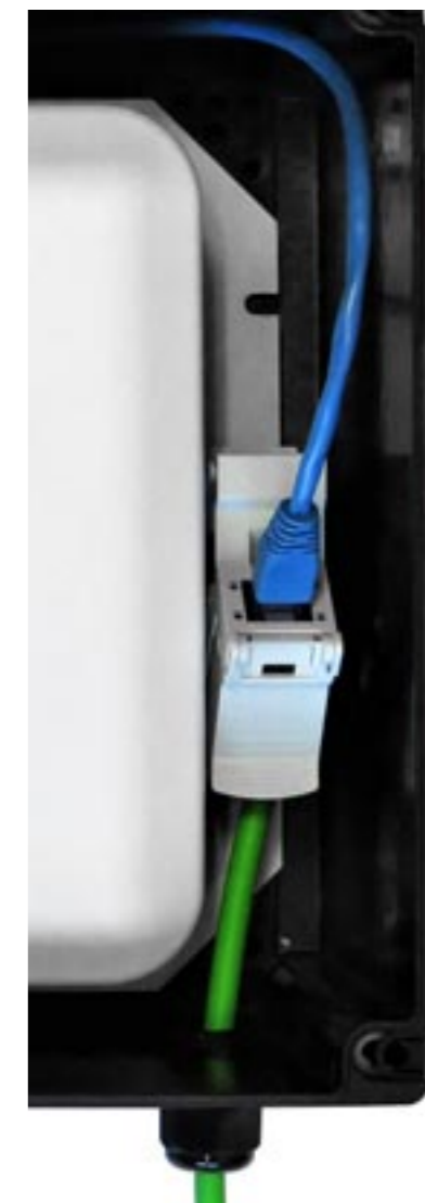
Batch-Kabel (Verbindung Anschlussmodul zum Access Point)
