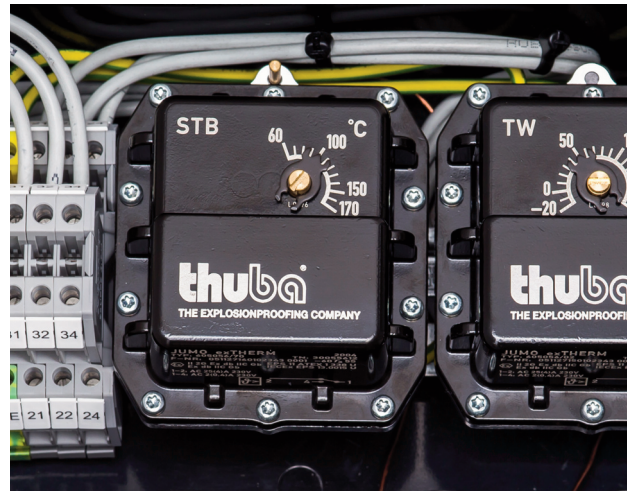
Temperaturüberwachungssystem mit Temperaturregler und Sicherheitstemperaturbegrenzer Typ TMS
